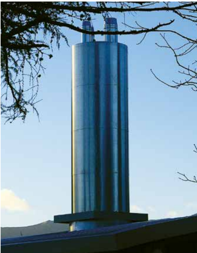
Sistema Super ICS Edificio scolastico, UK
