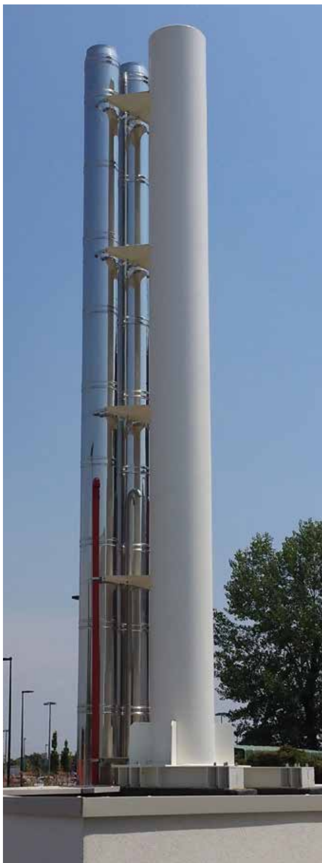
Sistema Super ICS Impianto multiplo Struttura ospedaliera, Zingonia
