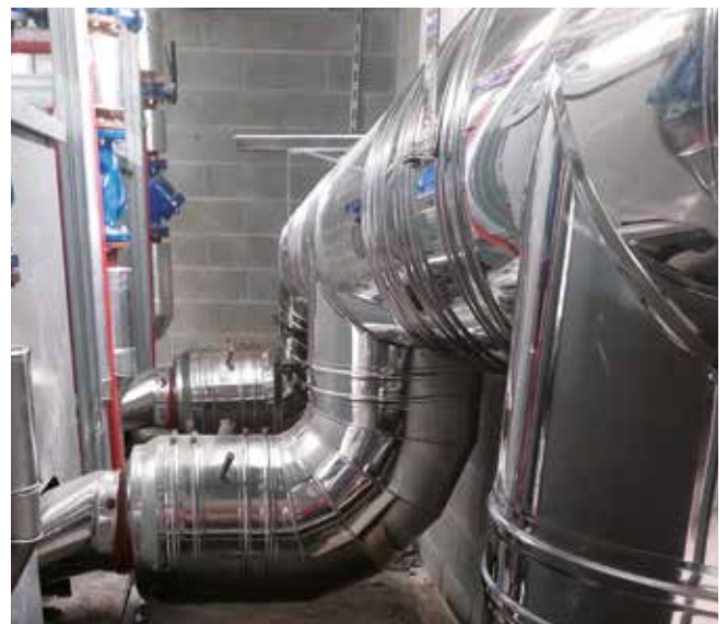
Sistemi Super ICS e ICS 5000 Impianto multiplo per gruppi elettrogeni, motopompe antincendio, cappe cucina, Torre Velasca, Milano
