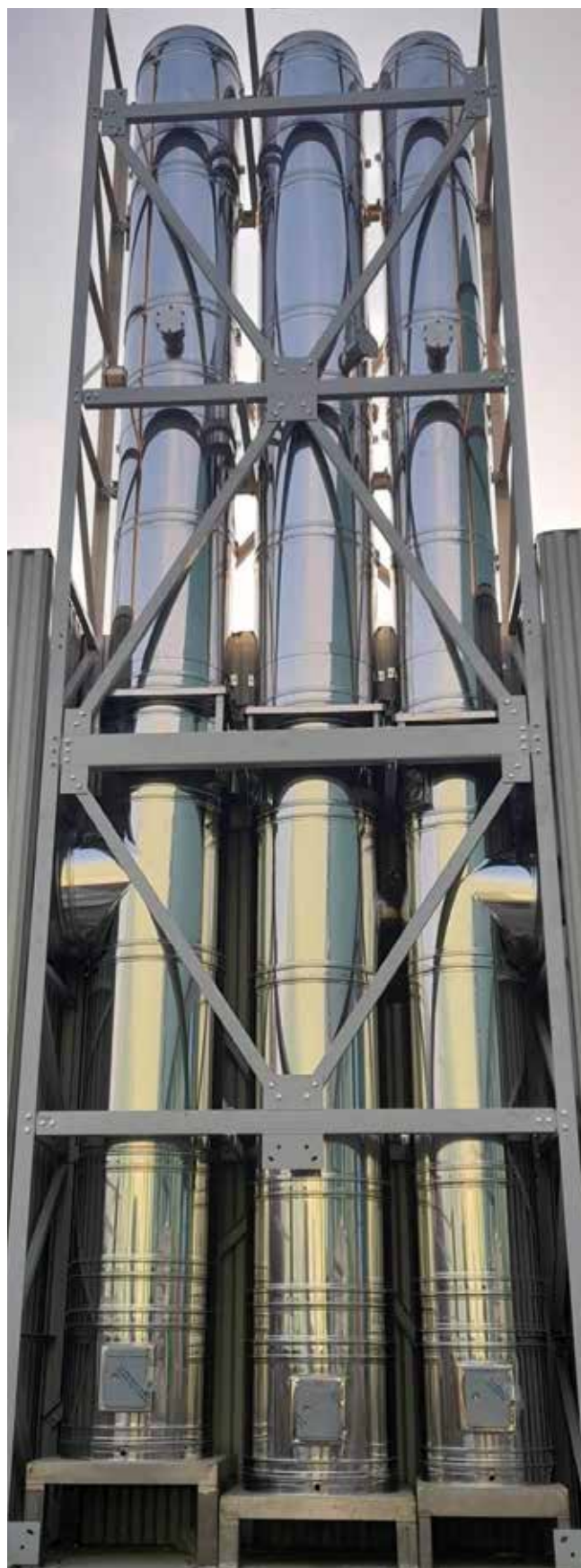
Sistema ICS 5000 Impianto asservito a centrale termica Sito industriale, Bergamo
