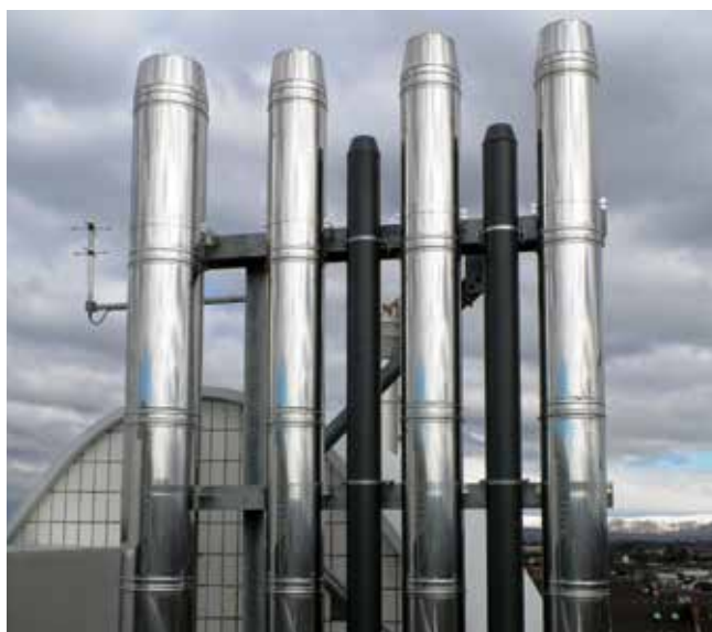
Sistema camino ICS Impianto multiplo Struttura ospedaliera, Glasgow
