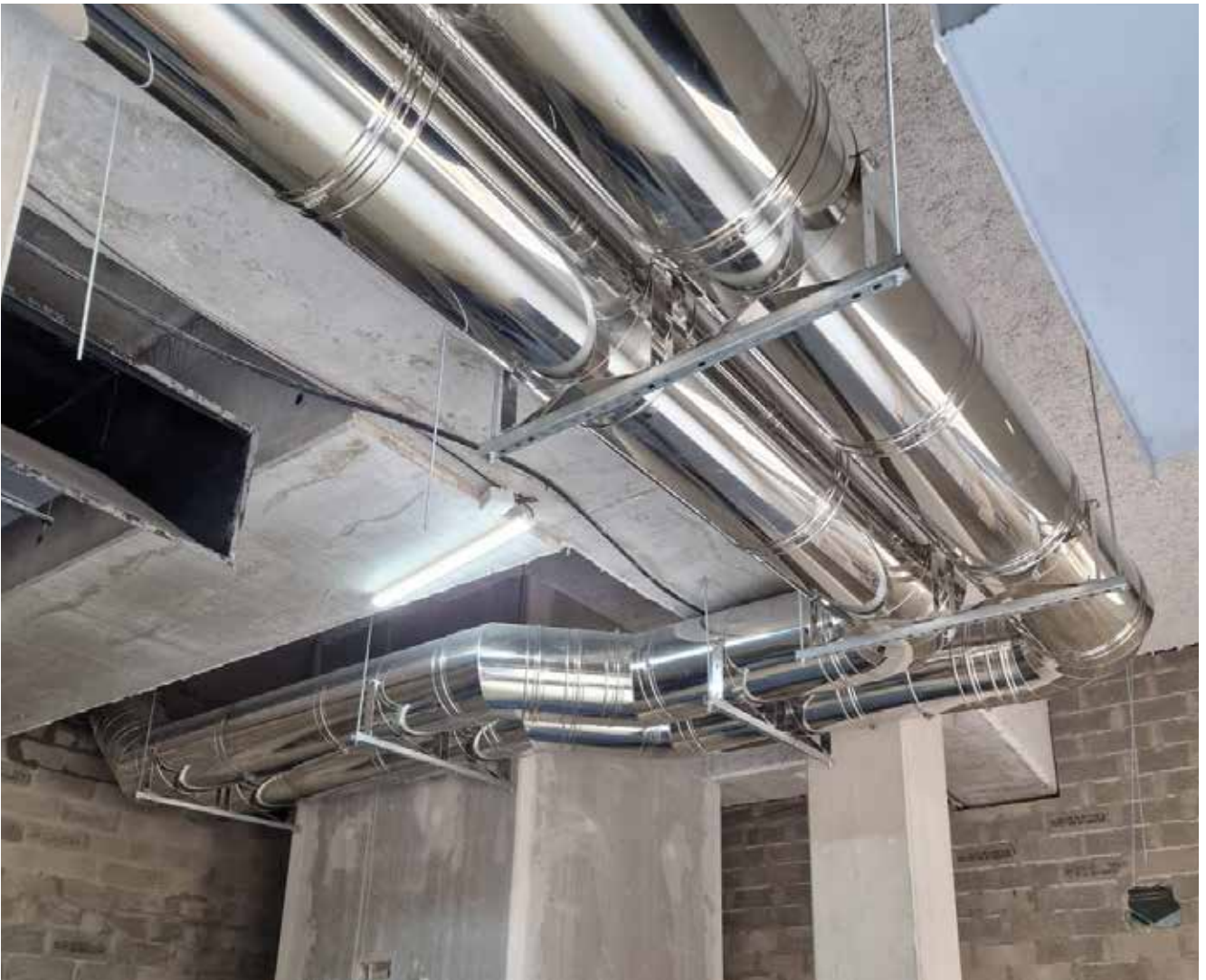
Sistema camino ICS 5000 in applicazione E120 Vano tecnico in edificio pubblico, Francia
