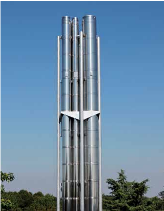
Sistema ICS 5000 Centrale Termica, Lissone, Italia
