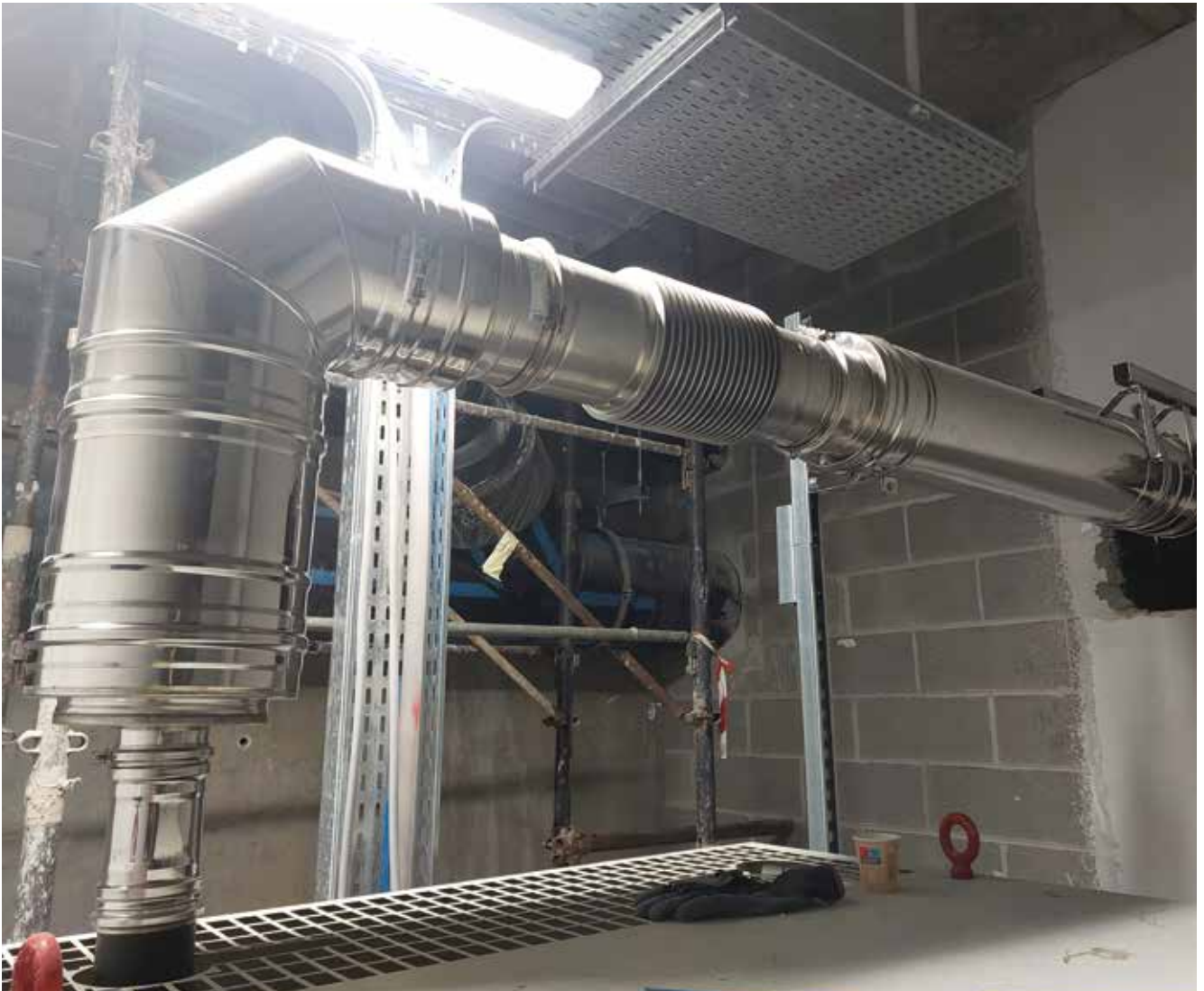
Sistema ICS 5000. Gruppo elettrogeno per motopompa antincendio, Citylife, Milano
