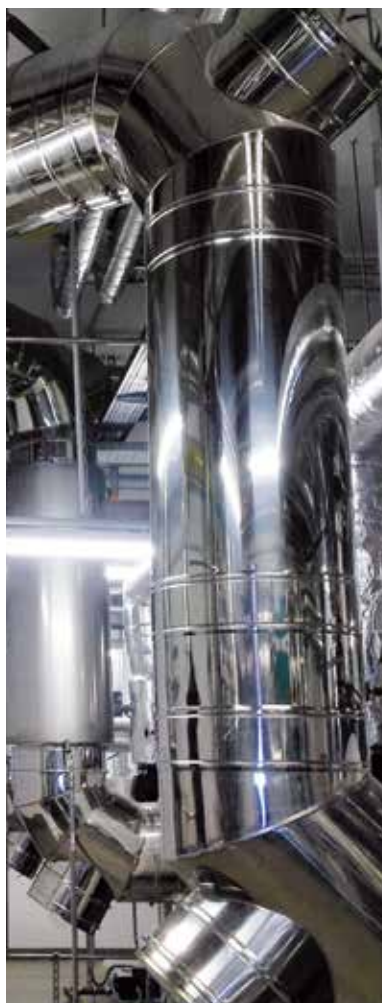
Esempio di impianto fumario Super ICS asservito a centrale termica, struttura ospedaliera.
