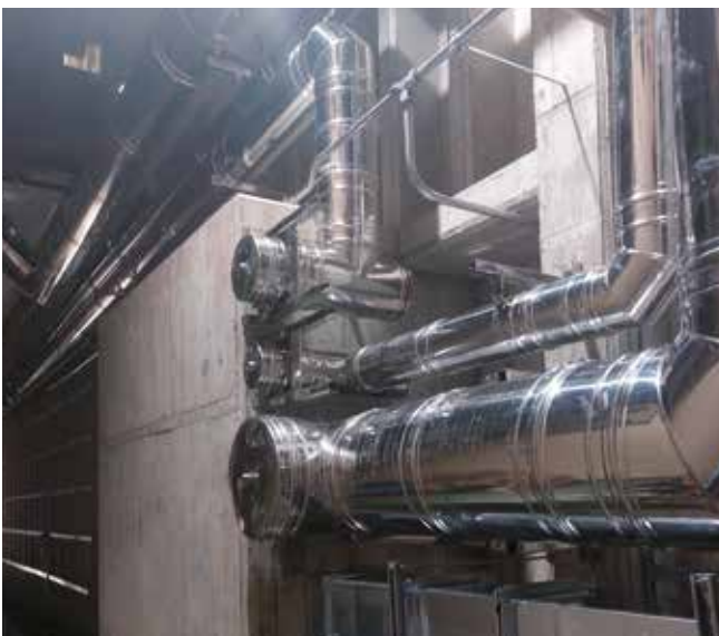
Sistemi Super ICS e ICS 5000 Impianto multiplo per gruppi elettrogeni, motopompe antincendio, cappe cucina, Torre Velasca, Milano
