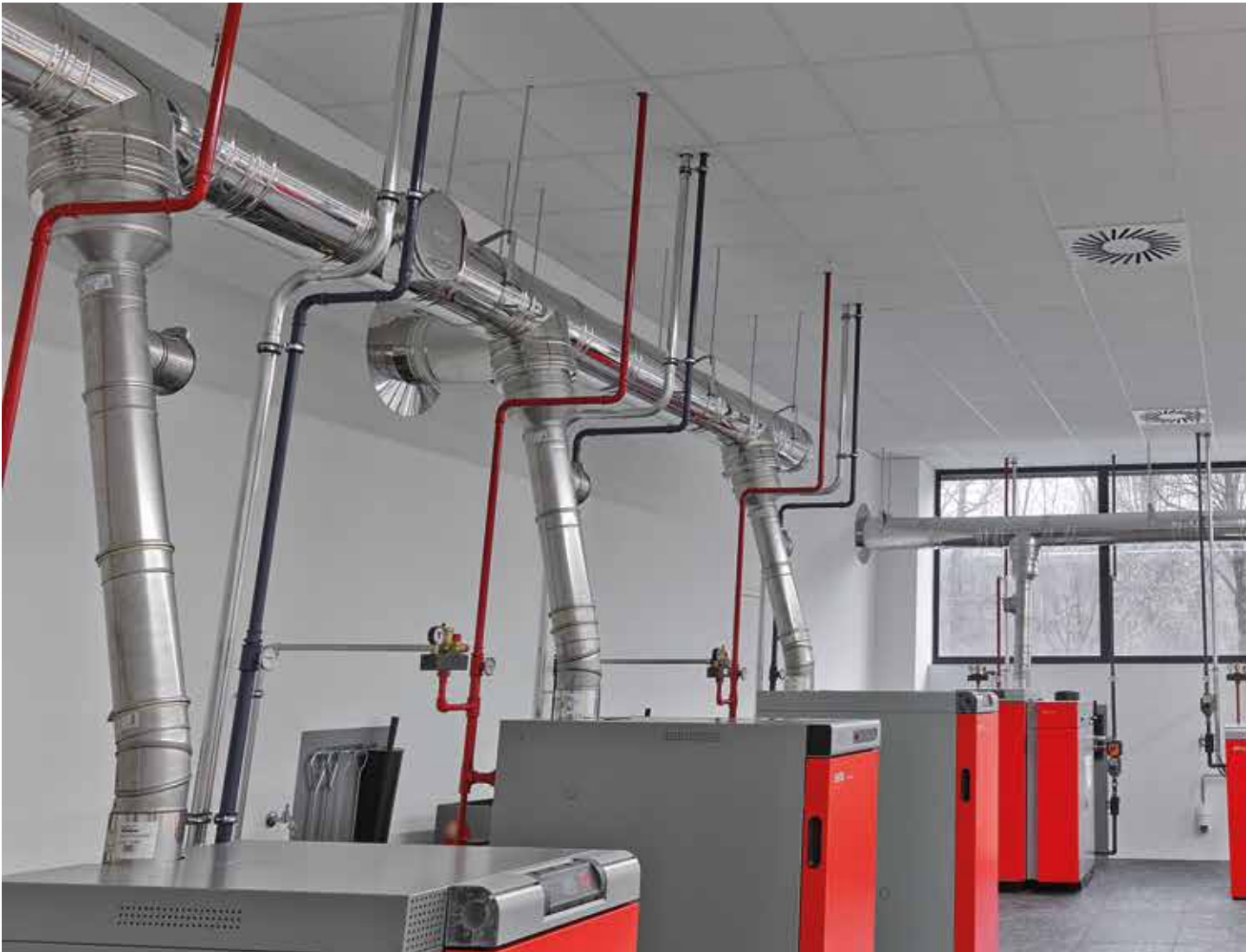
Sistema camino - ICS e mono parete Prima Plus. Impianto a cascata. Generatori a biomassa, Austria
