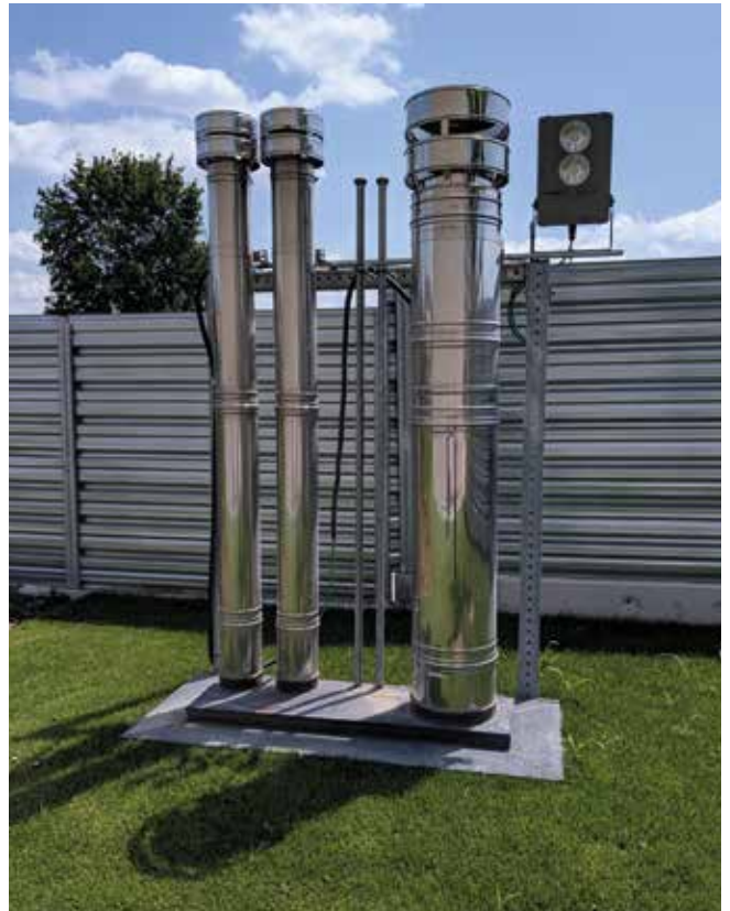
Sistema ICS 5000 e HP5000 Impianto asservito a motopompe antincendio. Sede direzionale telecomunicazioni, Milano
