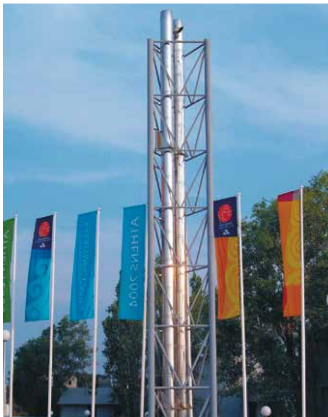
Sistema Super ICS Struttura olimpica, Grecia
