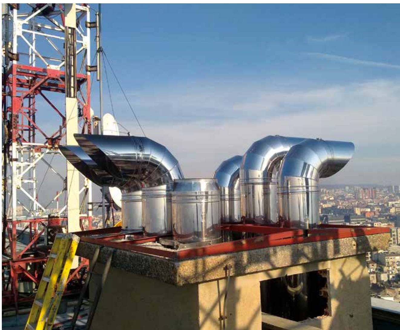
Sistema camino - ICS 5000 Sede direzionale telecomunicazioni, Serbia
