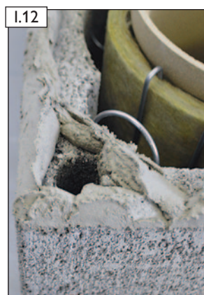
I.12 ACHTUNG! Auf geschlossenen Stegbereich achten!
