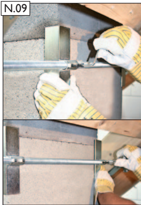
N.09 Spannwinkel an den Schornstein drücken. Abreißschrauben anziehen bis der Schraubkopf an der Sollbruchstelle abreißt.
