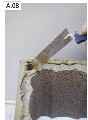
ACHTUNG! Auf geschlossenen Stegbereich achten!
