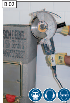
B.02 Mit Winkelschleifer Öffnung herstellen. ACHTUNG! Beachten Sie bitte die Hinweise zum Arbeitsschutz auf Seite 2!
