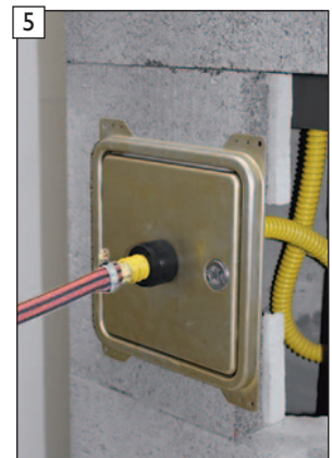
Beispiel: bauseitige Ableitung mittels Schlauch 3/4"
