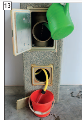
Kondensatteller und Siphonschlauch spülen.
