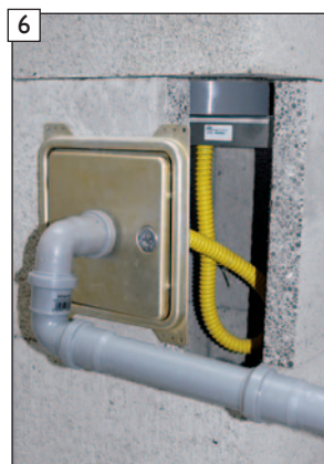
Ableitung mit HT-Rohren DN40 mit Aufweitungen zum Bodenablauf vor dem Schornstein.
