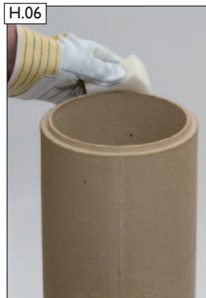
H.06 Unterseite des Putztüranschlusses-Formstückes (PA-Formstück) säubern.
