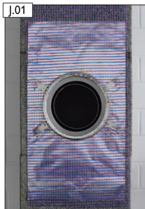
Ansicht Feuerstättenanschluss mit eingebautem Schiedel Edelstahl-Anschlussfutter:
