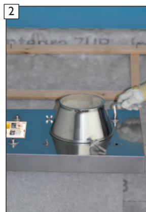
2 Beide Inbusschrauben der Zulufkopfplatte-Edelstahl mit Silikondichtungen und Unterlegscheiben an der Abgaszugseite heraus-schrauben.
