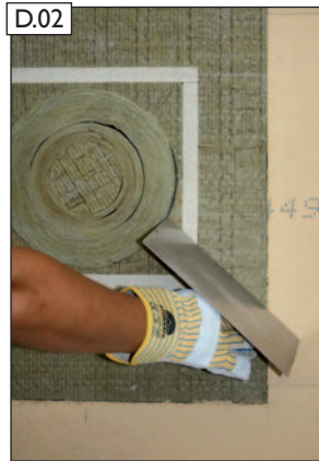
Bauseitige Wärmedämmung auf bündigen Sitz prüfen.
