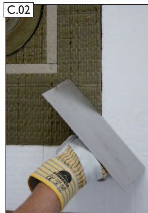
Bauseitige Wärmedämmung auf bündigen Sitz prüfen.
