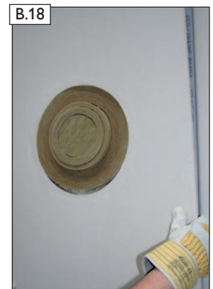
Fertige Gipskartonplatte wieder einbauen. ACHTUNG! Die Dampfbremse darf dabei nicht beschädigt werden!
