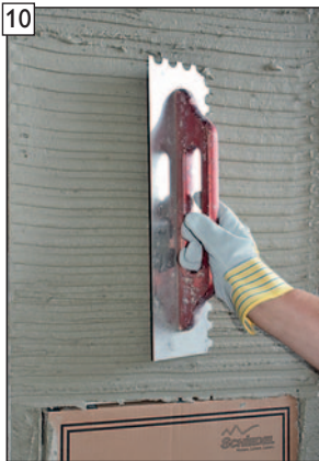
10 Oberflächenverzahnung für späteren Oberputz mit Zahntraufel (Zahnung ca. 10mm) in Haftbrücke einbringen.
