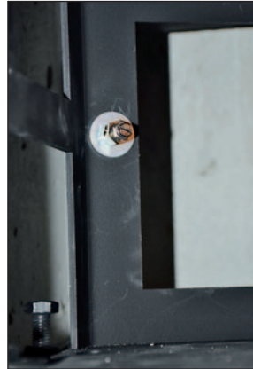
Ansicht der werkseitig verbauten Potentialausgleichsanschlussklemme.
