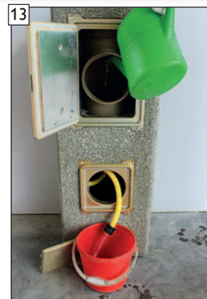
Kondensatteller und Siphonschlauch spülen.
