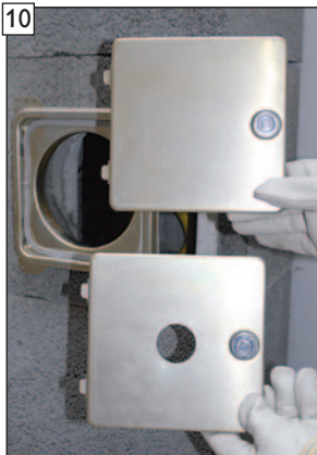
BlowerDoor Kondensatblendentürblatt wieder einsetzen.
