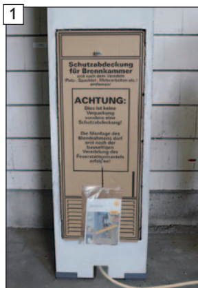
Ansicht der werkseitigen Schutzabdeckung nach Beendigung der bauseitigen Veredelungsarbeiten am Feuerstättenmantel.
