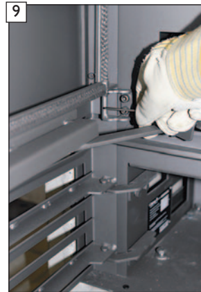
... Zuluftblende müssen dazu nicht entfernt werden.
