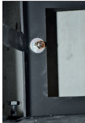
Ansicht der werkseitig verbauten Potentialausgleichsanschlussklemme.
