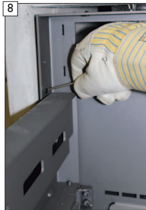
Die Feuerraumtür und ...
