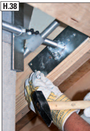
H.38 Firstseitigen Sparrenhalter mit Kammnägeln (D) ohne vorzubohren ausnageln (siehe Nagelbild Zwischensparrenmontage).
