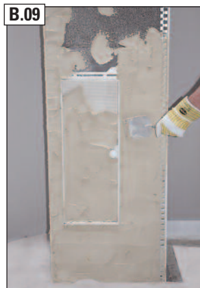
B.09 Anbringen des bauseitigen Unterputzes auf den Design-Fertigfuß und den Putzträger der BlowerDoor-Design-Fertigfußtür.
