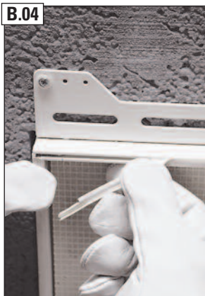
B.04 Detailansicht Bereich Türscharnier mit bauseits zurückgeschnittener Schutzdichtung im Bereich des Türscharniers.
