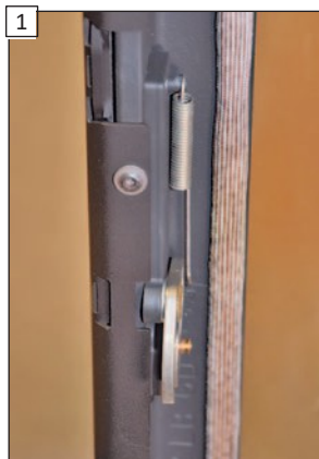
1 Pohled na zlomenou pružinu zavírače dveří.
