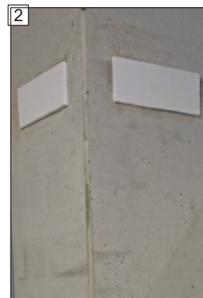
2 Horní otvory pro konvekční vzduch je nutné na místě uzavřít omítkou.
