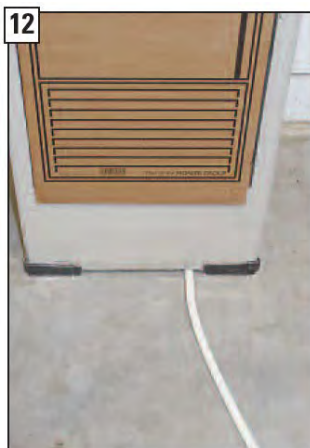
Pohled na připravené instalační vedení ze strany stavby od spotřebiče KINGFIRE CLASSICO S k rozvaděči.
