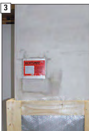
Pohled na vnitřní ochranný kryt.
